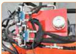
2 electroválvulas de doble efecto y depósito de aceite
